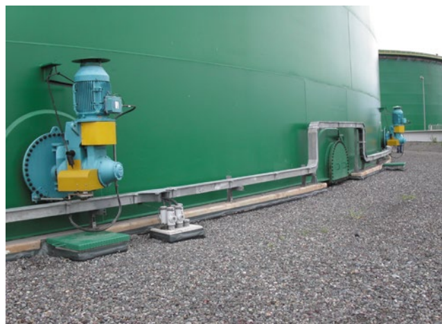
Mieszadła z obrotową przekładnią 55 kW oraz automatycznym siłownikiem
